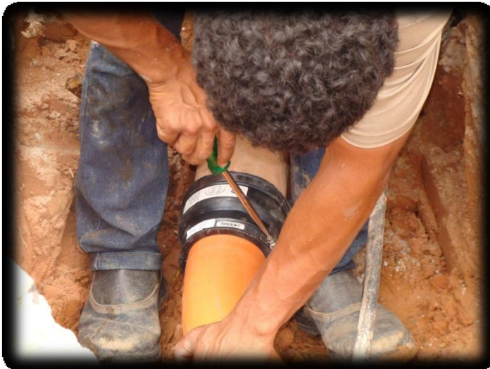
Conexão com a saída de esgoto (local a ser monitorado)
