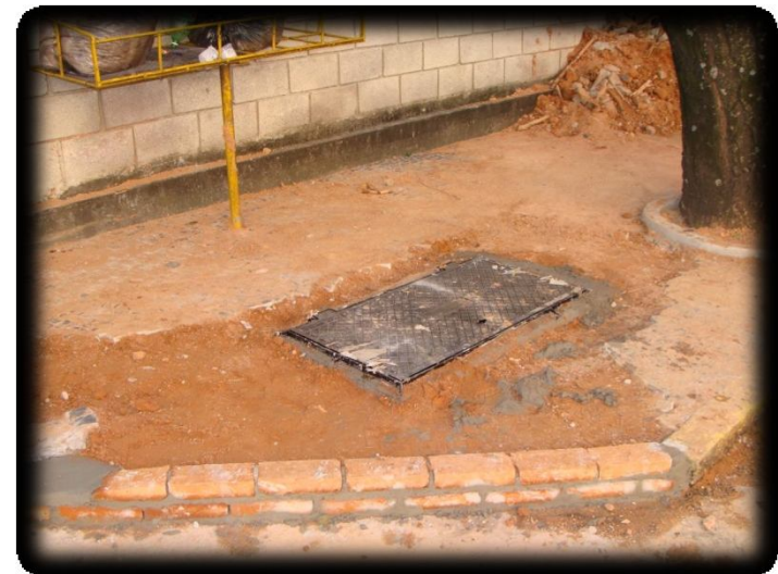
Equipamento instalado (visão final)
