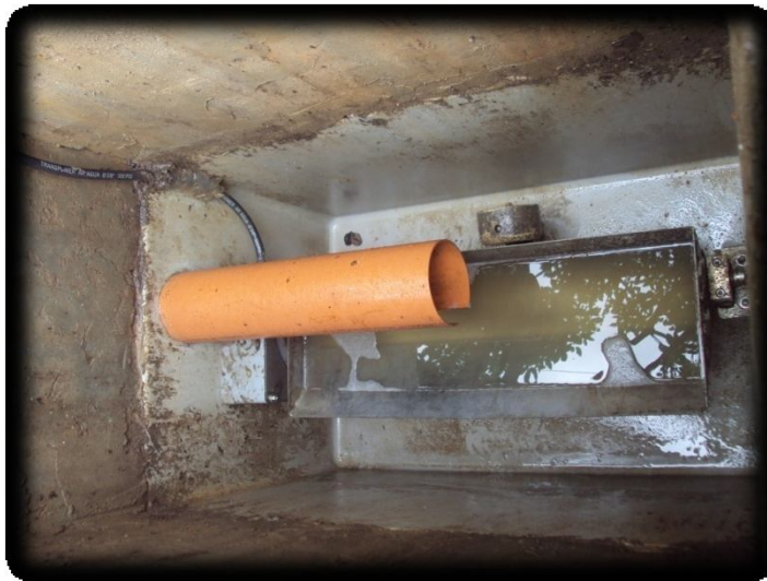
Equipamento em funcionamento
